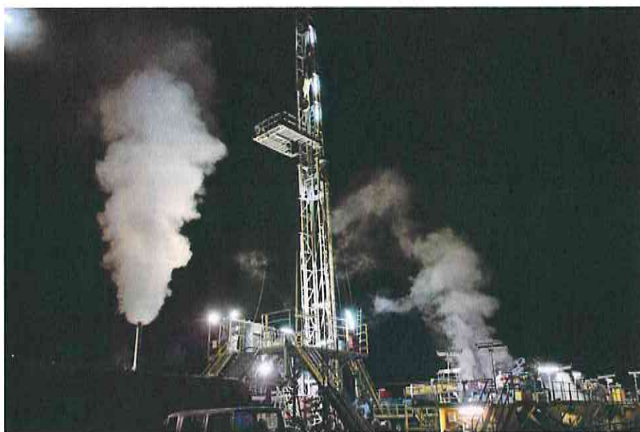
Geotermikus kút Kistokaj
